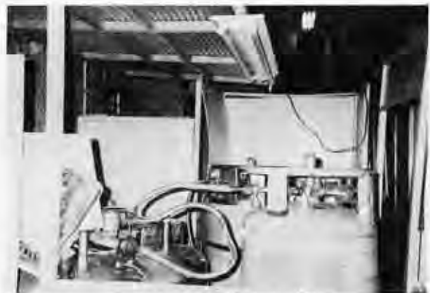
パーティションが曲がったボンベ置場
